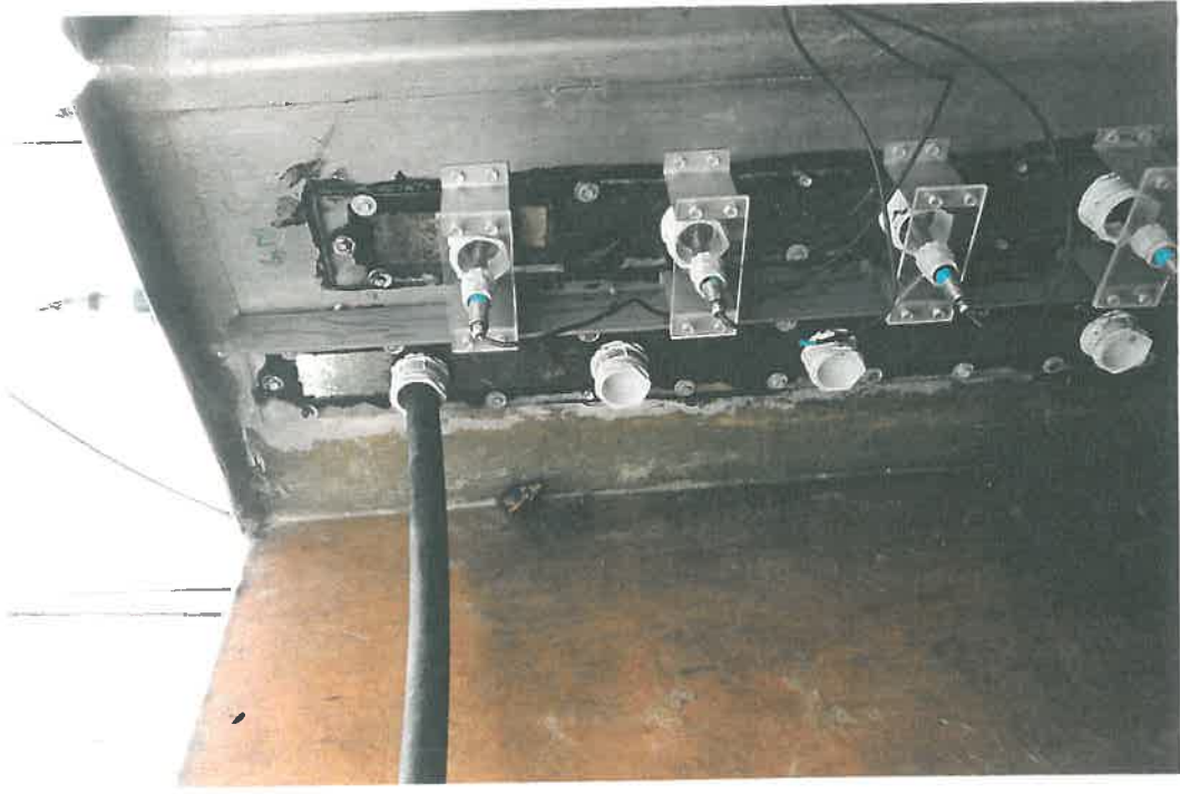
Photo L-3 : installation du Vertiscope : capteurs horizontaux et dispositif de réglage du niveau de la nappe fissurale, Gardel-INRA.
