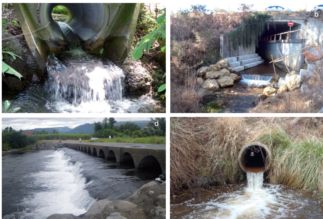
Exemples de chutes en aval d'ouvrages routiers.
