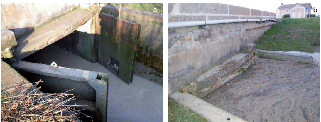
Exemple des portes à flots au niveau de la Jalle de la Maréchale dans le Médoc (33), (a) à basse mer, (b) à pleine mer.
