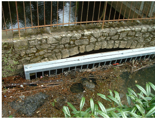
FIGURE 2.19 – Grilles qui filtrent l'eau à l'aval du bassin de stockage pour éviter que les embâcles atteignent le Parc de Procé
