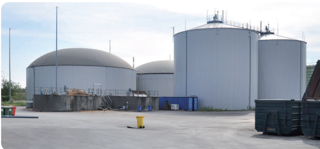
Installation de méthanisation ■ Mathieu Lesteur
