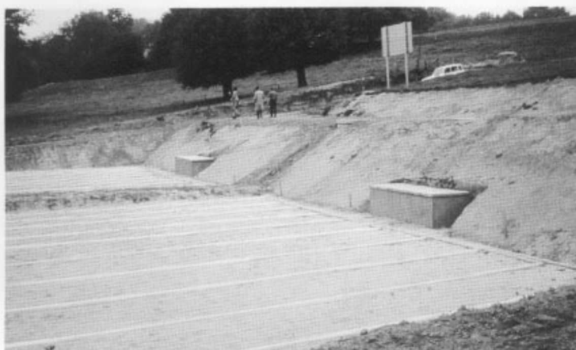
Réseau superficiel de tuyaux de répartition à Andouillé (53).
