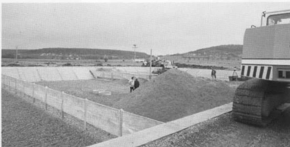
Cloisonnement de la station de Saubures les Vannes (54).
