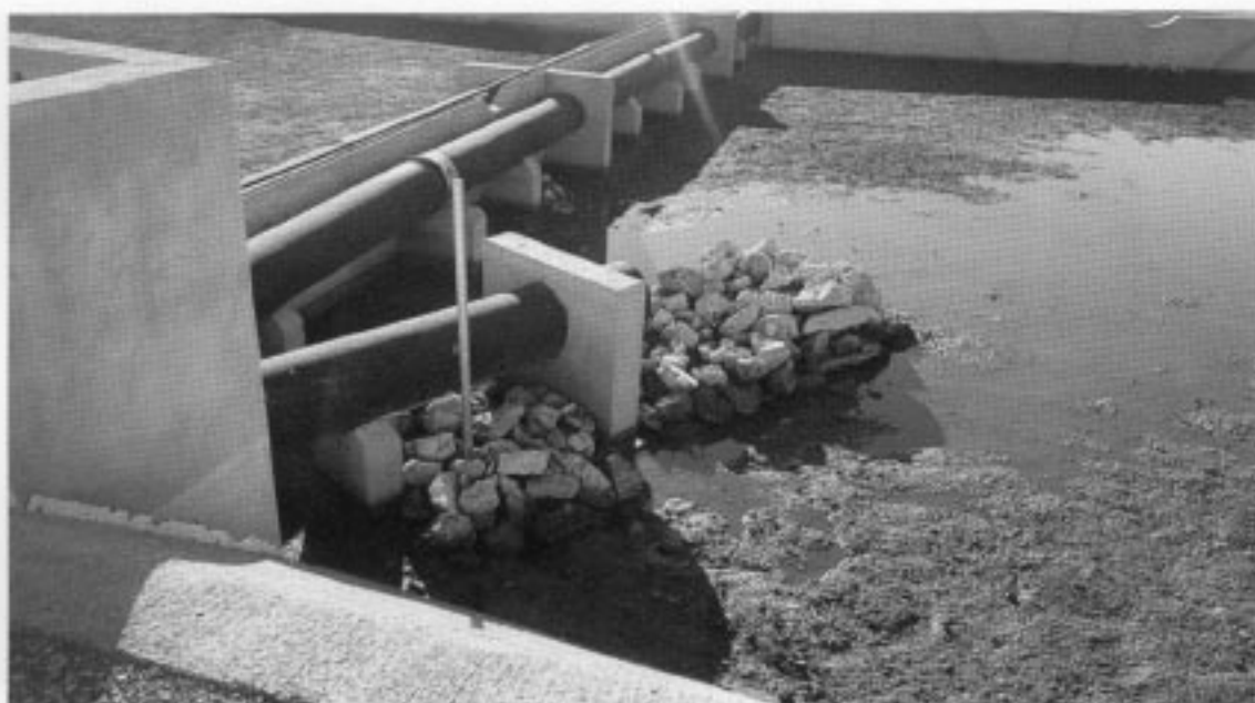
Alimentation du dispositif de Mantpeyroux (34). Le jet est brisé sur des enrochements.
