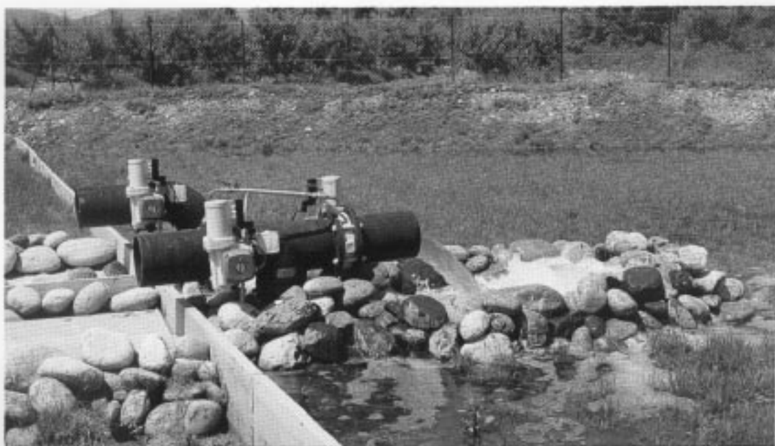
Alimentation des unités d'infiltration d'Aubenas (07) commandée par des électrovannes pneumatiques et réception sur dalle béton et gros galets.
