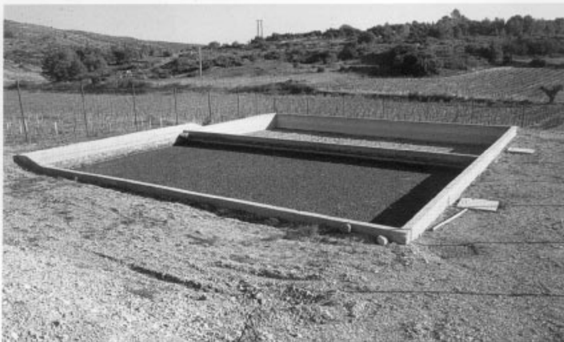
Lits de séchage des boues du décanteur-digester de Montpeyroux (34)
