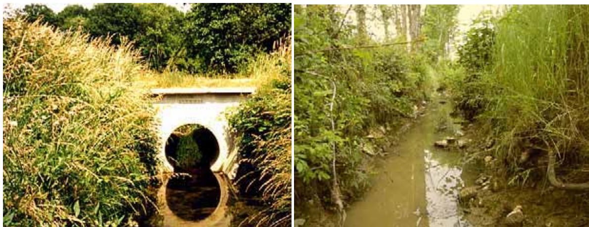
Planche 1 : exemples de facteurs de ralentissement des écoulements dans les fossés d'assainissement agricole. A gauche : buse de franchissement faisant obstacle. A droite : végétation -Photographies prises dans le lit du ru de Melarchez- (Toutes les prises de vue de ce document ont été effectuées par l'auteur ou en sa présence par des étudiants stagiaires)
