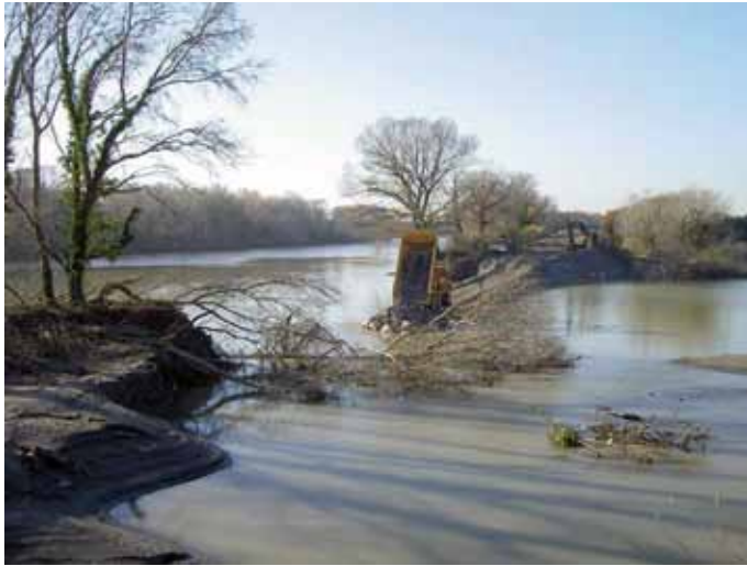
Photo 2 – La brèche de Petite Argence. ©SYMADREM
