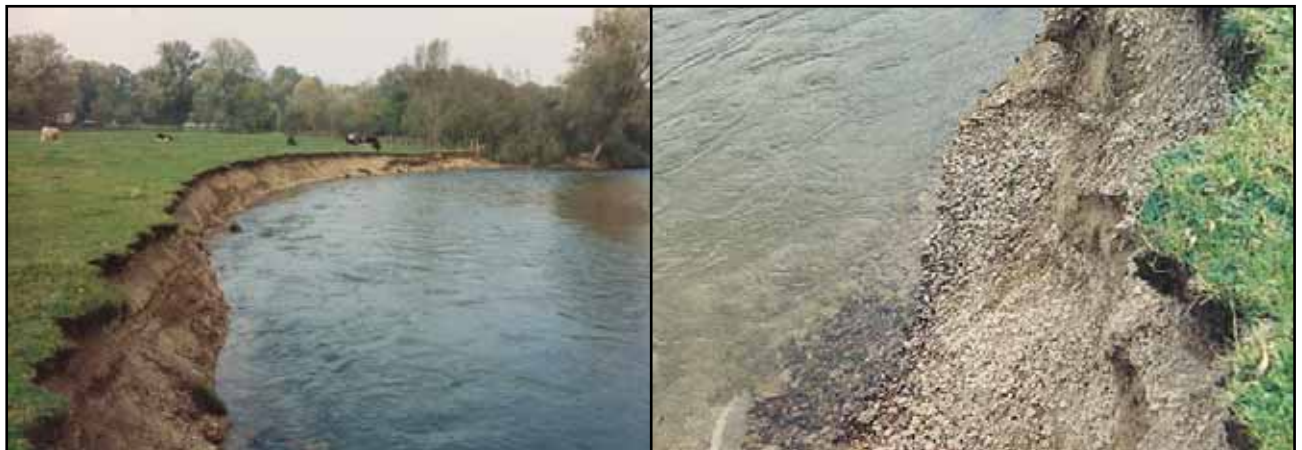
Figure 29. Exemple de berges facilement affouillables en présence de graviers non cohésifs sur une rivière à "faible puissance" (photos Biotec).
