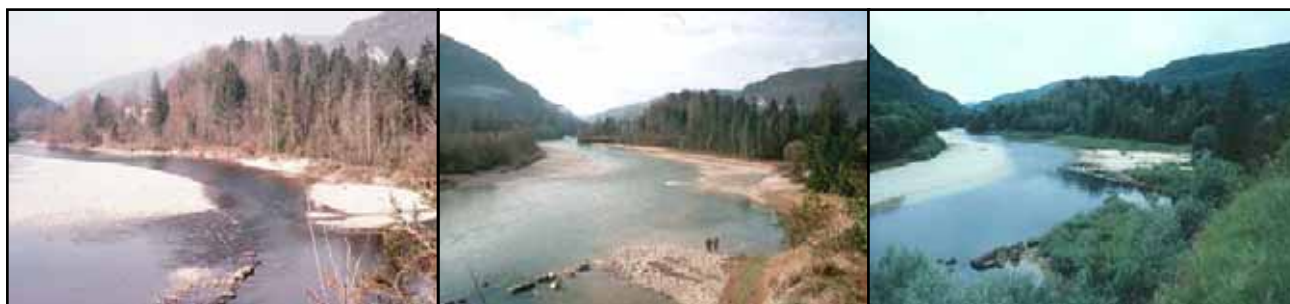
Figure 38. Vues de travaux de reconstitution de berges par des techniques indirectes (déflecteurs) sur la Bièvre. La végétation riveraine adaptée est ainsi partiellement spontanée sur les dépôts favorisés par les épis (illustration de gauche avant travaux, au centre en fin de travaux et à droite 4 ans plus tard) (photos Biotec).
