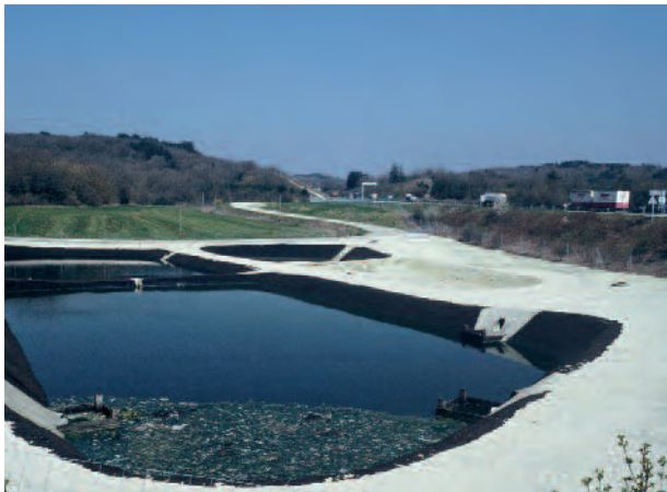
Bassin de réception des eaux de pluie, au bord de l'autoroute du Jura.
