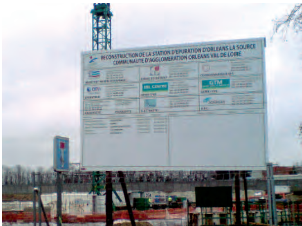
Mise aux normes de la STEP de La Source.
