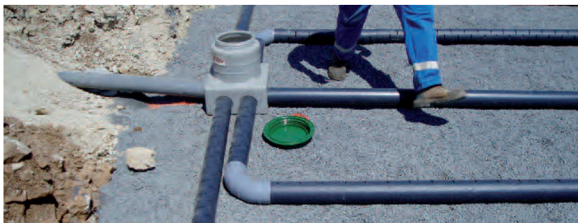
Amélioration de l'assainissement collectif et autonome : ici un filtre à sable pour un particulier.
