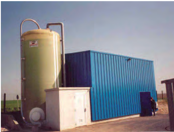
Unité de dénitratisation.
