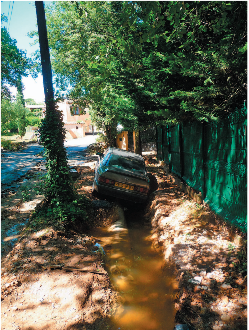
Chemin détruit par les ruissellements dus aux pluies intenses du 16 juin 2010, © P. Cantet, 2010.
