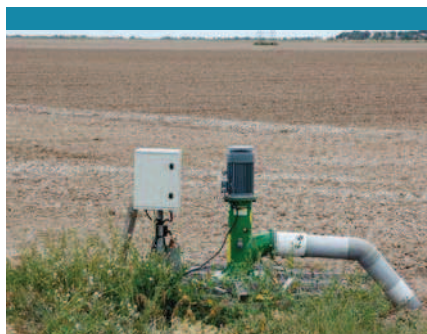
Pompage dans les masses d'eau
