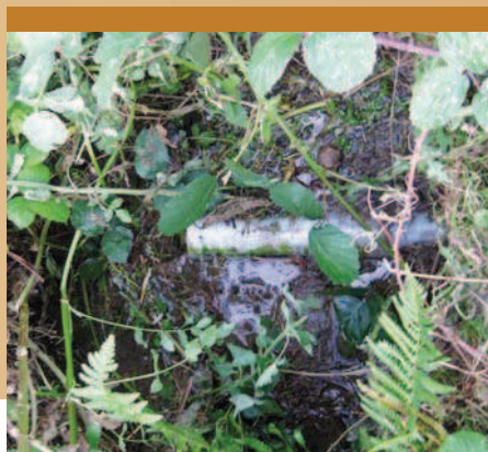
Sortie de drain enterré
