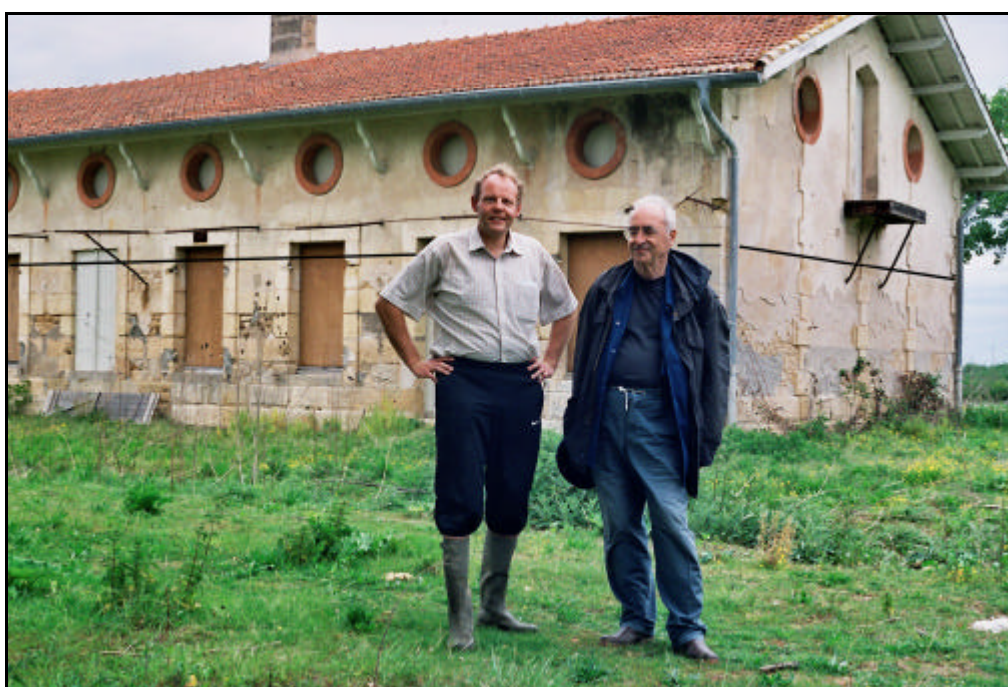
Figure 4 – Photographie prise devant une maison de l'Île Sans Pain montrant le niveau atteint par les eaux lors de l'inondation du 27 décembre 1999 (surligné par un trait noir). Le crépis a disparu en façade est (droite du cliché) jusqu'à hauteur de l'eau et la trace matérialise une différence de teinte sur le mur sud (gauche du cliché) à hauteur des gonds supérieurs des fenêtres (cliché 28 avril 2003)
