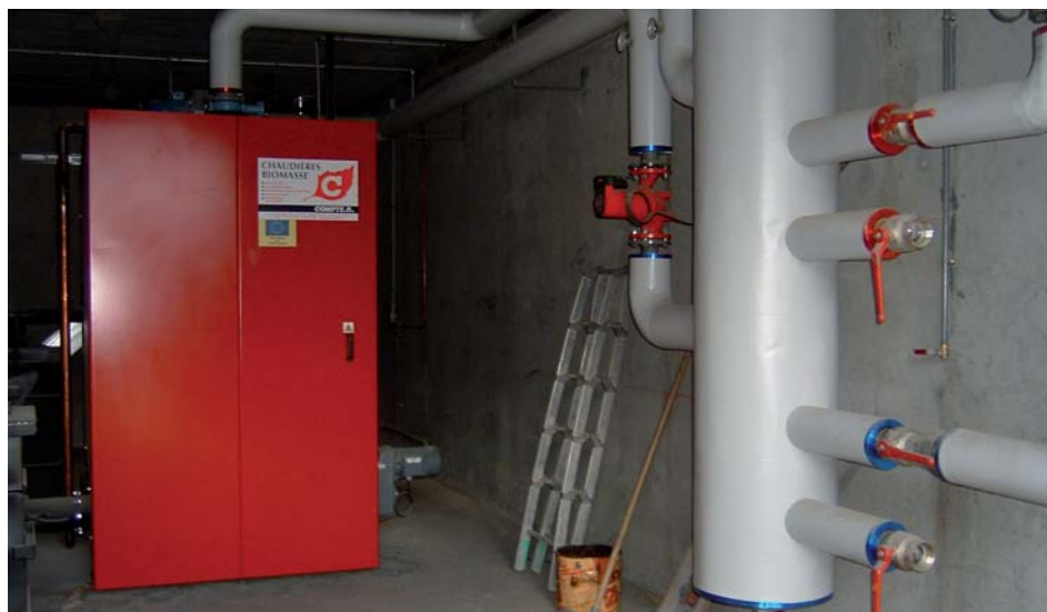
Exemple de chaudière de 500 kW pouvant alimenter un réseau de chaleur communal ou un collège et fonctionnant avec des plaquettes forestières (photo : OFME).
